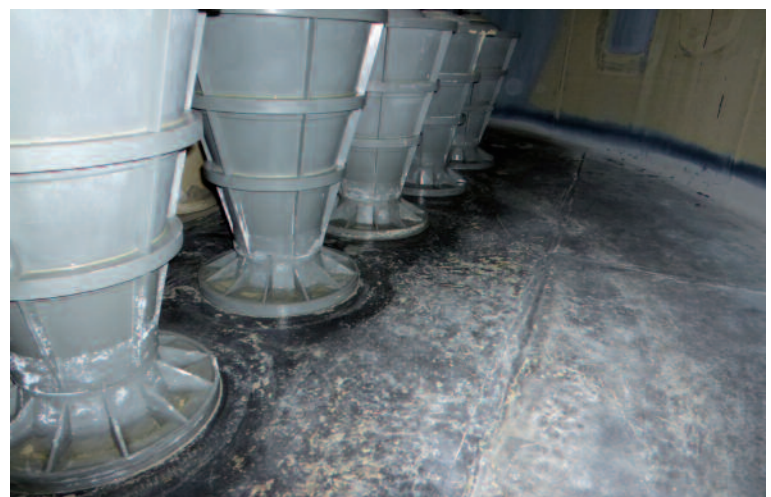
Rauchgaswäscher nach dem Einsatz von FINEAMIN HELAWAX
